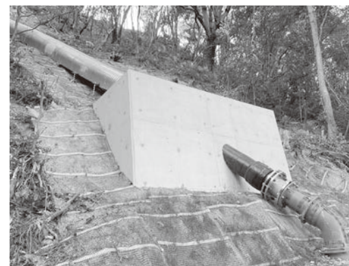
全長約1.1kmの串本地区緊急連絡管の一部
