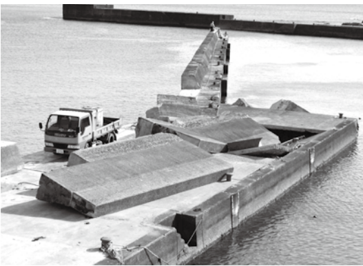
防波堤が崩れた田原川河口の船着場
