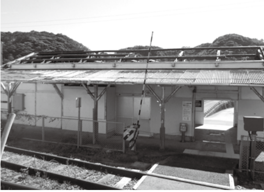
屋根が飛ばされたJR田並駅
