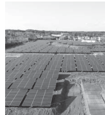
設置されている太陽光パネル（JFE電機㈱ 榊原さん提供）
