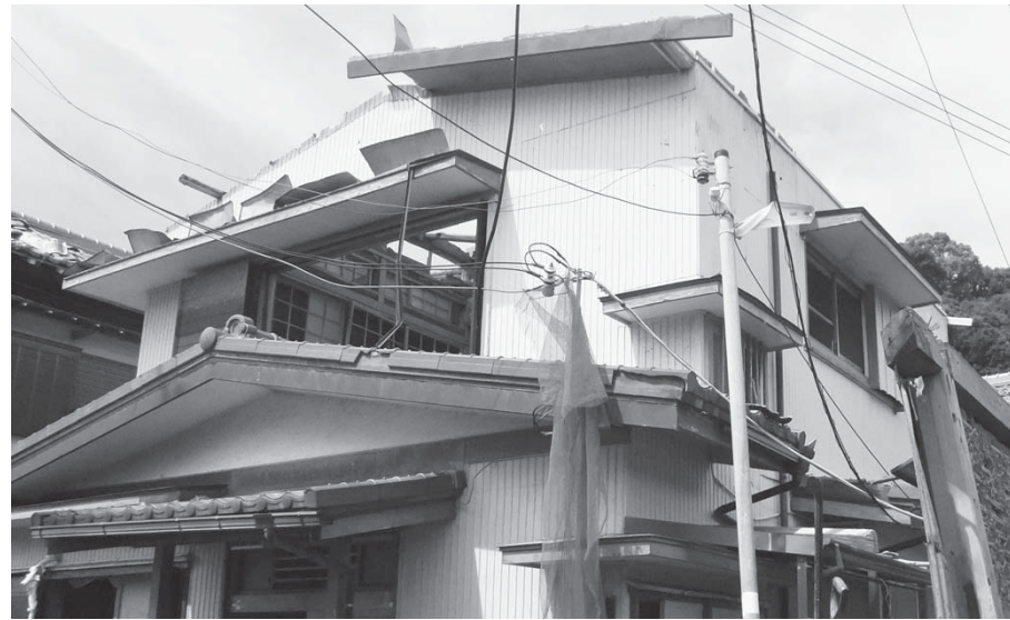
竜巻被害にあった住家。屋根が全て飛ばされています。（田並地区）
