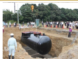
耐震性貯水槽の整備(上野山防災広場)
